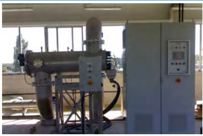
WWTP, El Escorial, Spain, 24 500 m 3 /day
