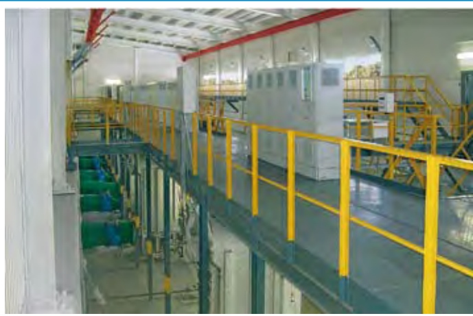
Kolpinskaya WTP, S. Petersburg, Russia, 250 000 m 3 /day
