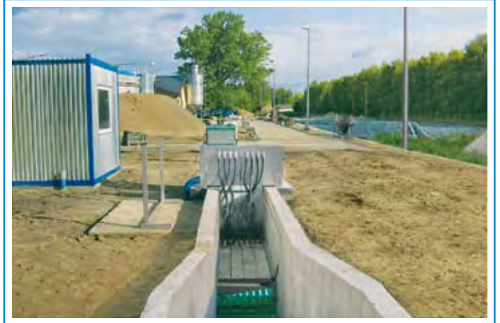
WWTP, Wiazowna, Poland, 10 800 m 3 /day
